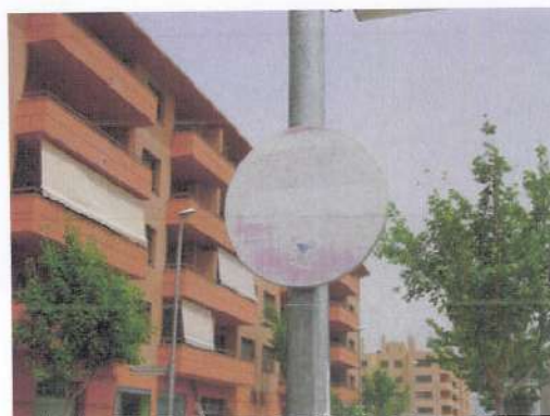
Senyal en estat deficient
