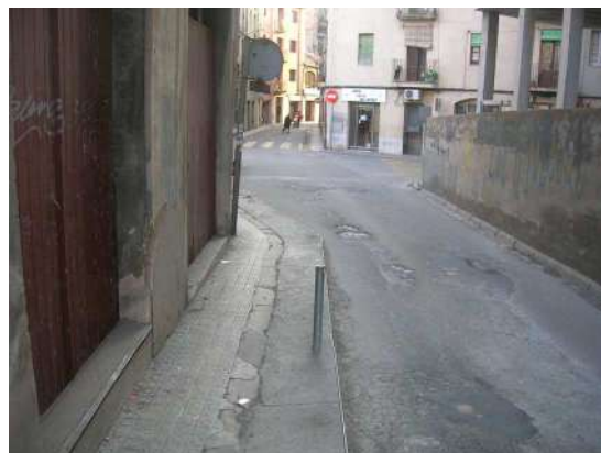
Imatge 19. Carrer Puigterrà de Dalt. S'ha eixamplat una vorera molt estreta de forma rudimentària. La vorera, no obstant, segueix massa estreta per a un pas còmode dels vianants.
