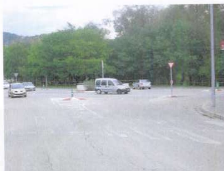
Senyalització horitzontal en estat deficient
