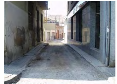
Amplada de vorera inferior a 0,90m
