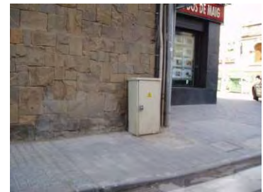
Armari d'instal·lacions mal ubicat
