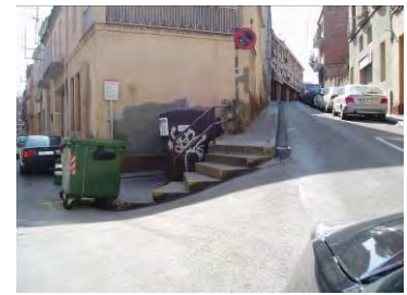
Escaleres mal dissenyades sense passamans
