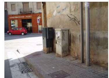
Armari d'instal·lacions i semàfor mal ubicats
