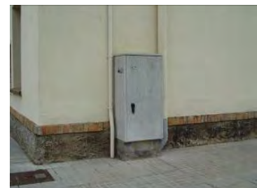
Detall armari instal·lacions mal ubicat
