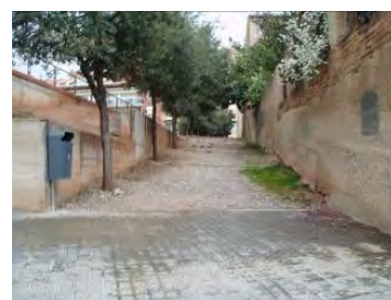
Detall plataforma única mal pavimentada
