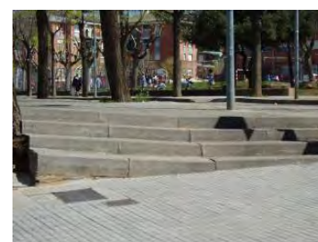
Detall escales mal dissenyades
