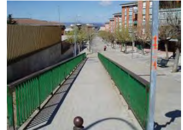
Detall rampa mal dissenyada
