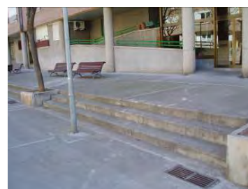
Detall escales sense baranes ni passamans
