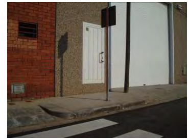
Detall pal d'instal·lacions mal ubicat
