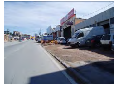
Detall inexistència de vorera Carretera de Vic
