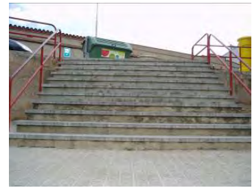
Detall escales mal dissenyades
