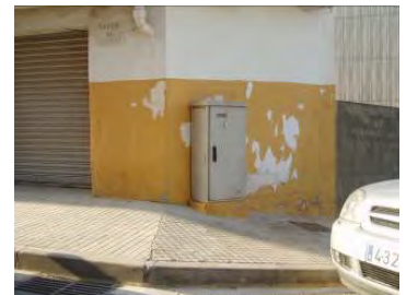
Detall armari d'instal·lacions mal ubicat
