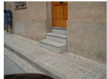
Detall escales accés casa molt perilloses
