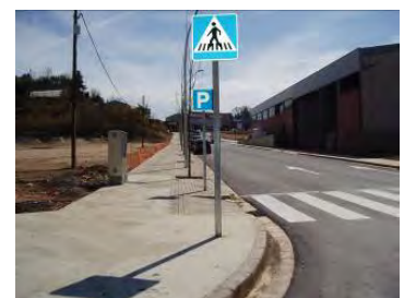
Detall armari d'instal·lacions mal ubicat
