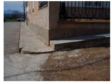
Detall graó aïllat molt perillós (Sol i Aire)
