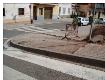
Detall paviment deteriorat
