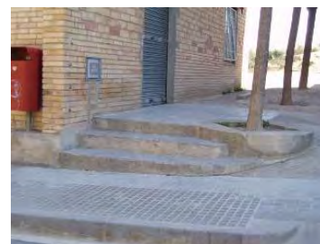
Detall escales mal dissenyades
