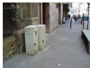
Detall Armaris d'instal·lacions mal ubicats
