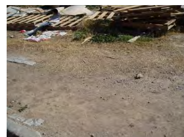
Inexistència de paviment a la vorera
