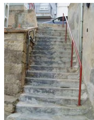
Detall escales mal dissenyades
