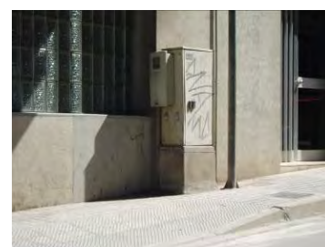
Armaris d'instal·lacions mal ubicat
