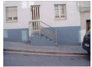
Detall escales accés casa molt perilloses
