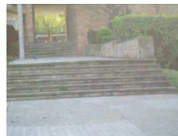
Detall escaleres sense baranes ni passamans
