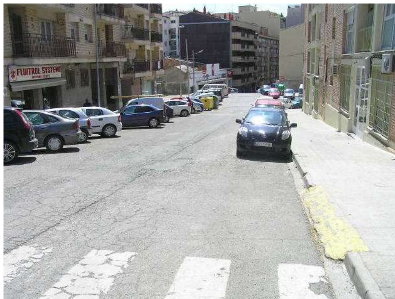
La senyalització no és prou clara i el paviment es troba en mal estat
