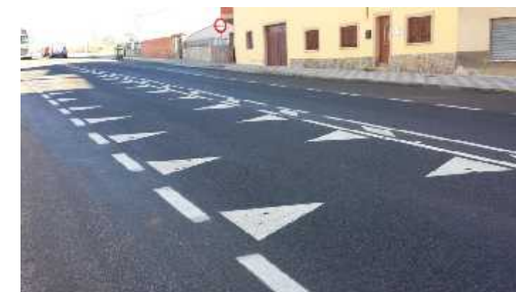
Dents de drac en calçada. Sant Boi de Llobregat
