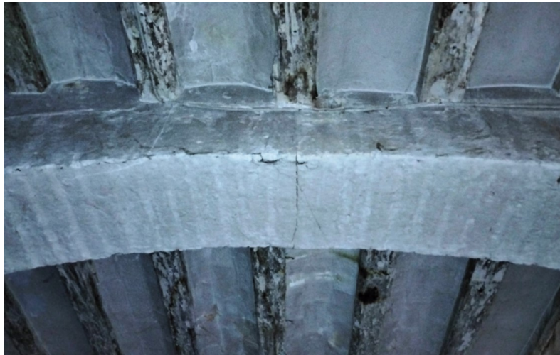
Fissura per tracció a la base de la clau
