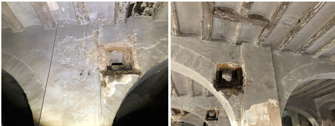
22111603 i 22011220. Exemples de perforacions dels estreps dels arcs diafragma del semisoterrani.
