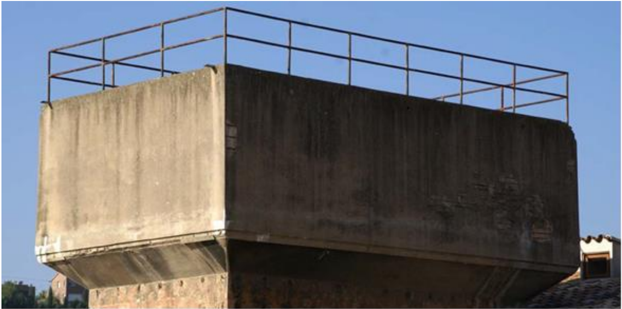
158 i 159. Estat del dipòsit de formigó armat situat al coronament del volum edificat annex. Font: Piqué i Escalè, 2010.
