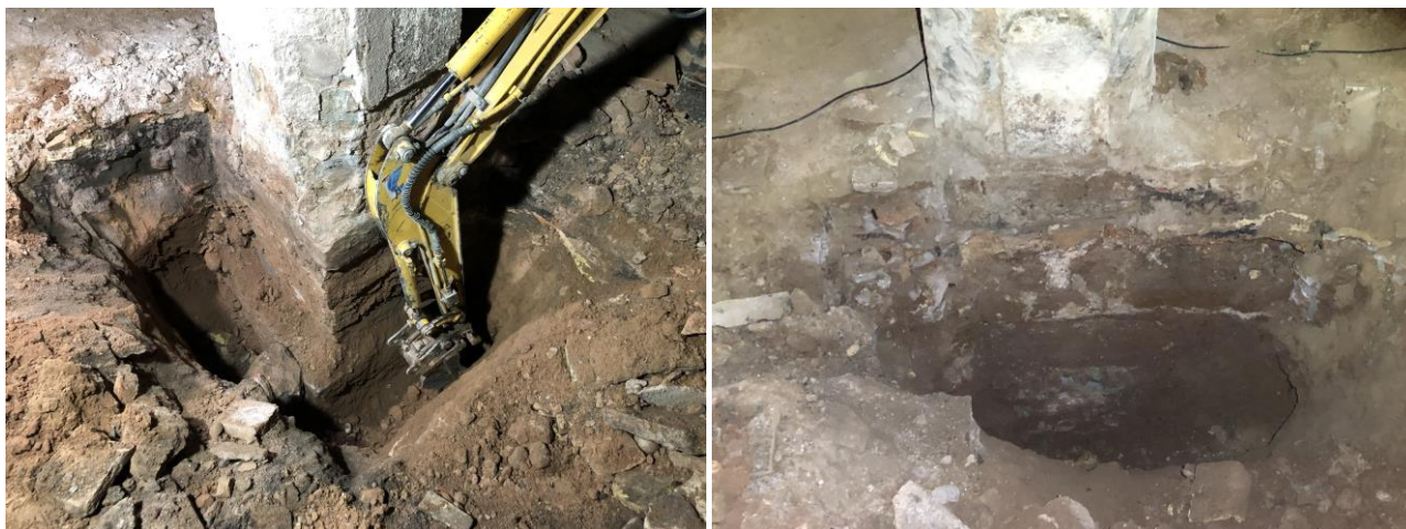
Imatges 22111522 i 22111537. Excavacions arran de fonament dels pilars centrals, en dos trams diferents, assolint fins uns 130cm de fondària.
