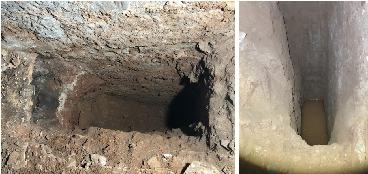
Imatges 22111522 i 22111537. Excavacions arran de fonament del mur de façana al riu, en dos trams diferents, assolint fins uns 230cm de fondària.
