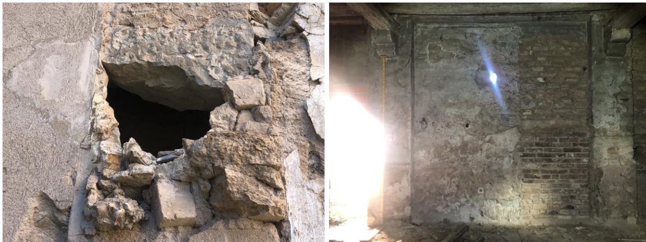
22100408 i 22100409. Exemple de perforació oberta a un tram de mur de façana.
