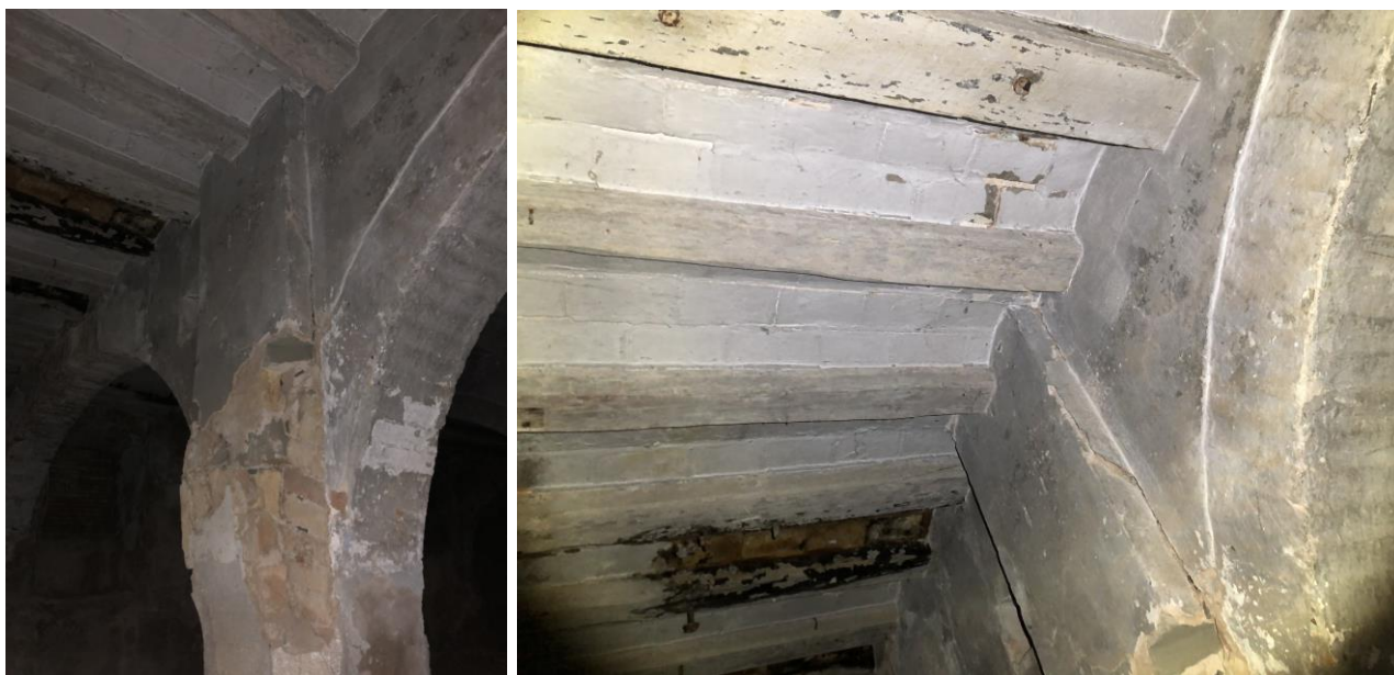
22111609 i 22111611. Imatges de dues zones de pilars del semisoterrani amb l'extrem superior amb deformacions o fissures.
