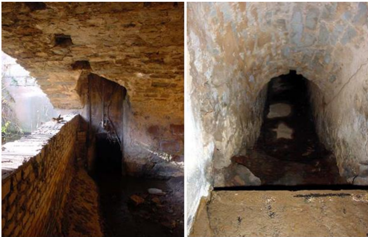
I34 i I35. Comporta de regulació de la primera galeria de desguàs sota el pont de l'extrem nord de la nau. Font: Piqué i Escalè, 2010.
