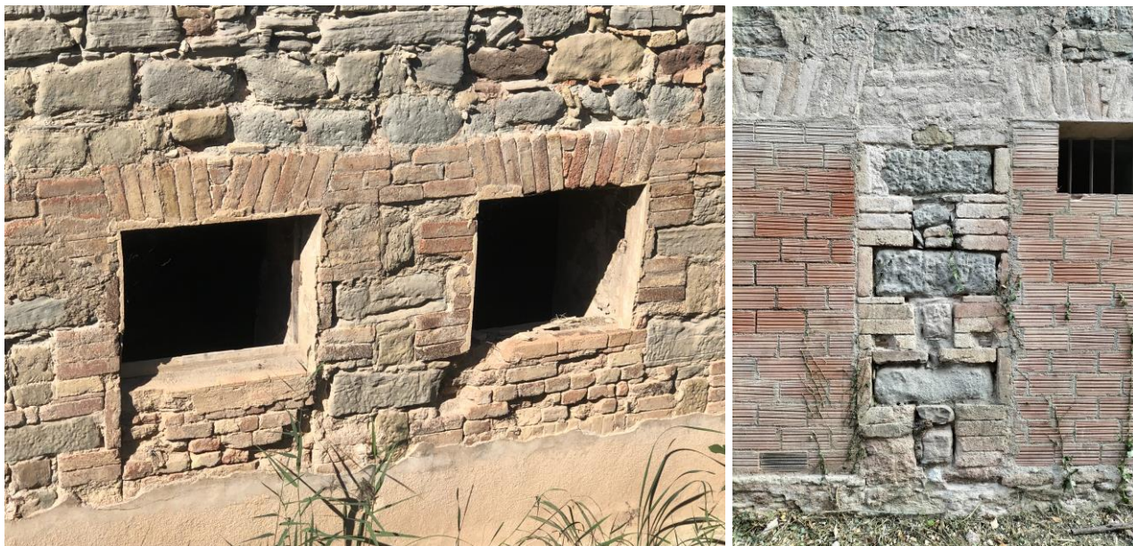
22100404 i 221125132827. Exemples de trams exteriors de façanes amb erosió i pèrdua de morter de rejuntat.
