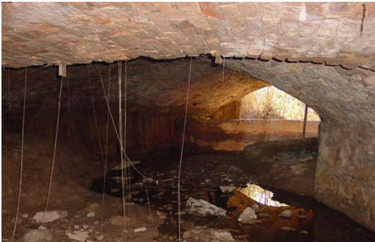
I32 i I33. Vista de l'ull del pont que cobreix l'arribada del canal a l'extrem nord de la nau. Font: Piqué i Escalè, 2010.
