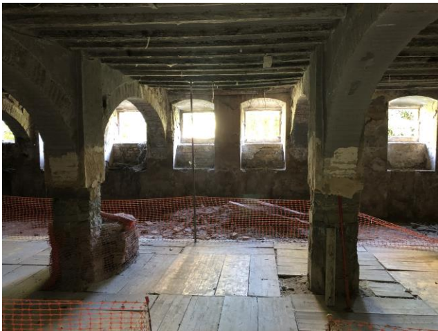
I30 i I31. Vista interior de la planta semisoterrani. Font: Elaboració pròpia.
