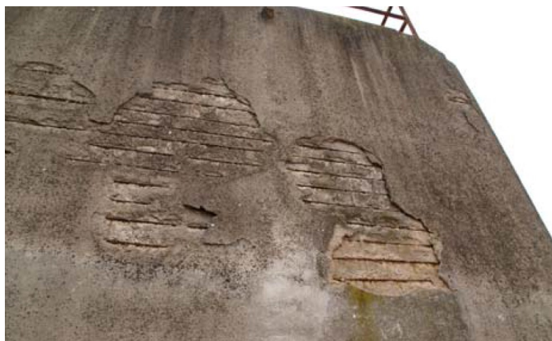
Murs laterals del dipòsit d'aigua. L'armadura presenta evolució avançada d'oxidació, provocant el despeniment del revestiment
