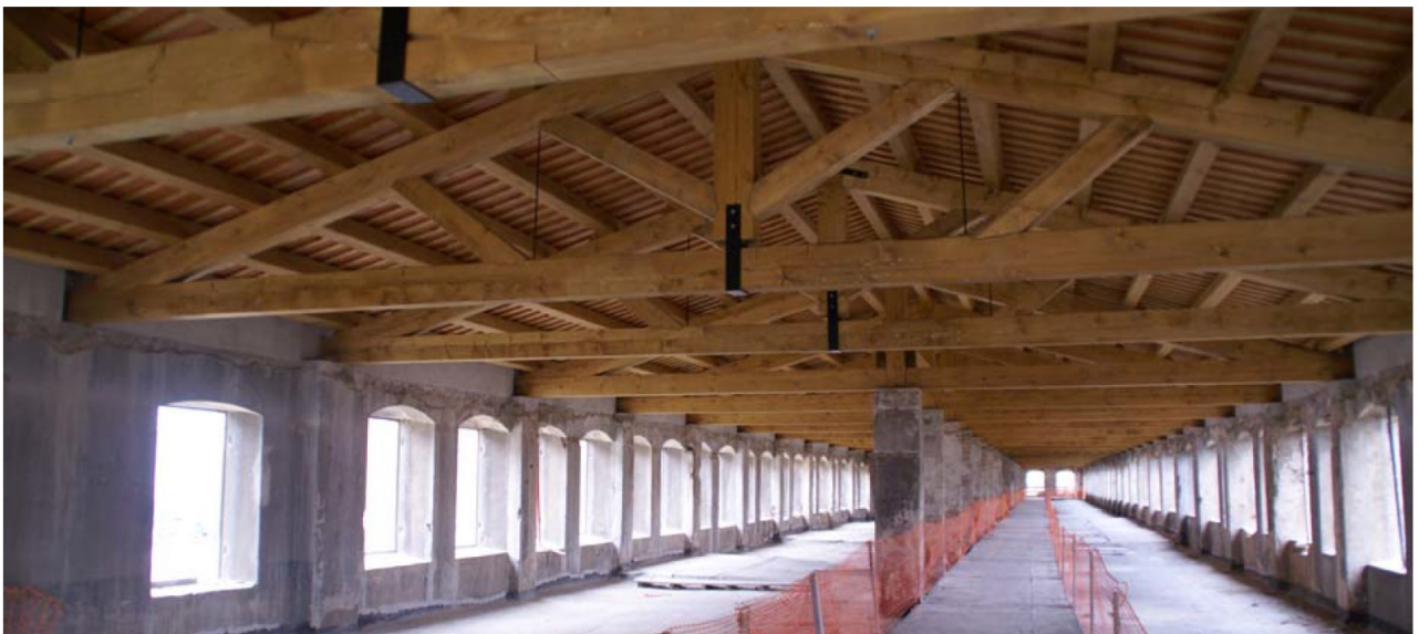
Coberta rehabilitada (2010) , que va suposar en gran mesura la interrupció de la degradació de forjats de planta
