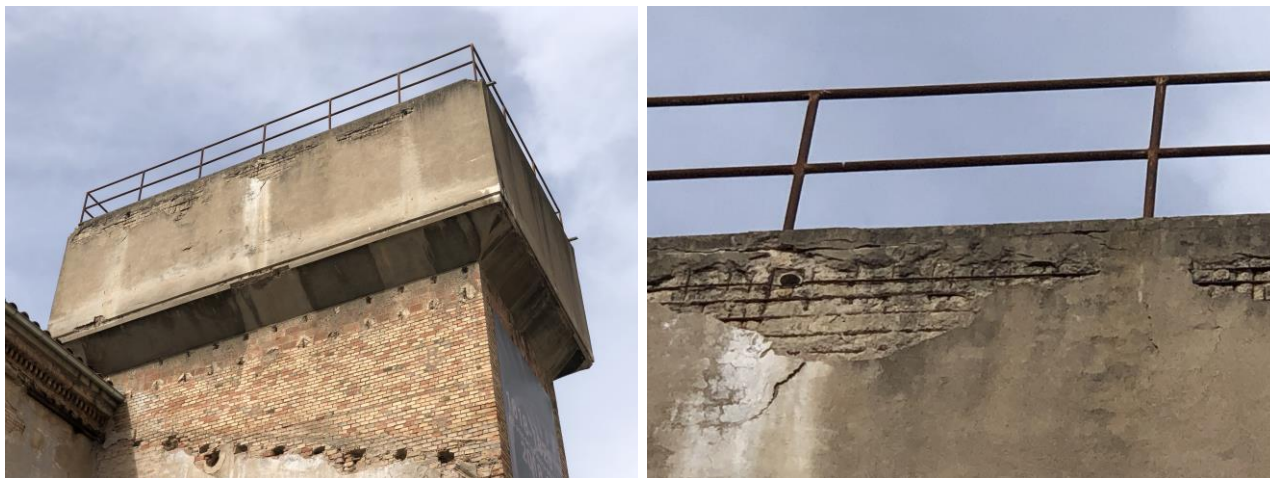
22101134 i 22101135. Aspecte general i detall de la degradació del formigó armat per oxidació de l'armat al dipòsit del volum annex a la nau.
