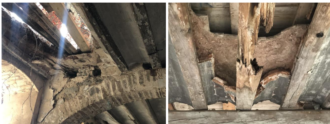
22011224 i 220729003. Exemples de trams amb esfondraments parcials del sostre unidireccional de bigues de fusta i revoltons.
