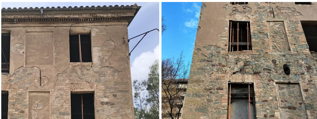
22101146 i 221125132344. Exemples de trams de murs de façana afectats per esquerdes i fissures a l'extrem nord de la nau.
