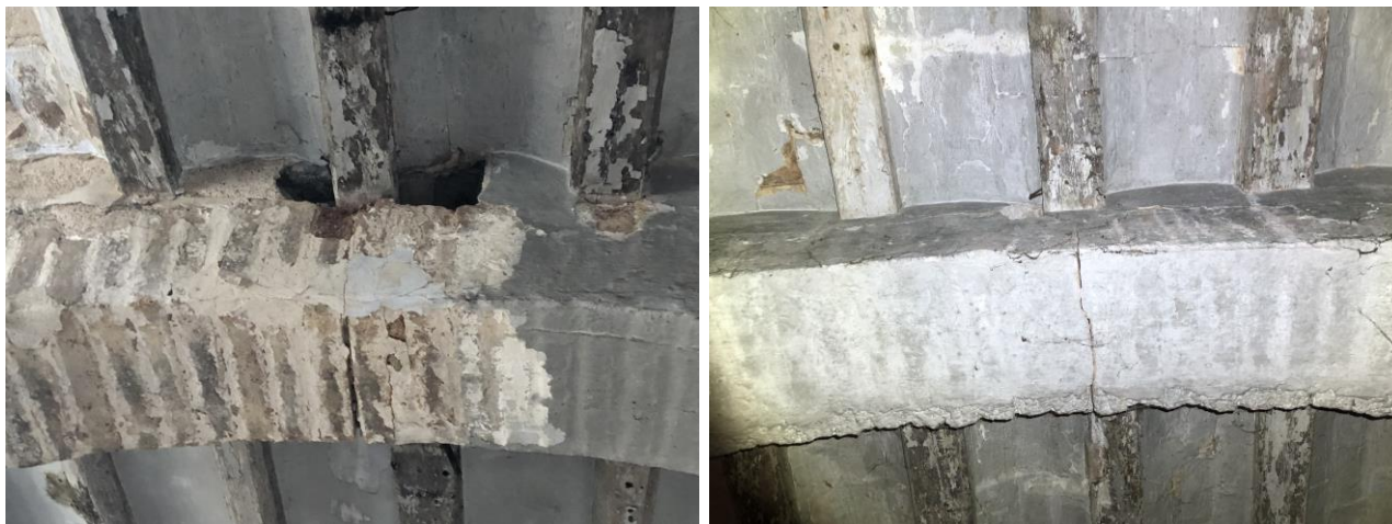
22011232 i 22111553. Exemples d'esquerdes i fissures al centre dels arcs diafragma del semisoterrani, més obertes a la cara inferior.
