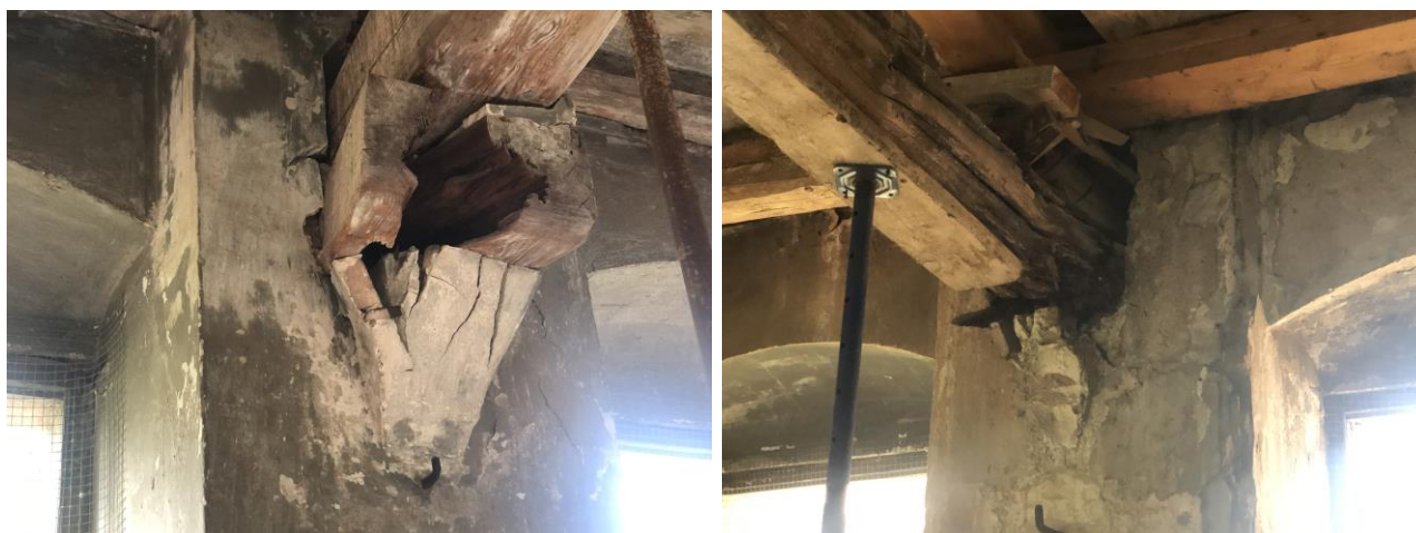
22072933 i 22072959. Exemples de degradacions amb podriments i trencaments parcials de caps de jàsseres de fusta i mènsules de recolzament.
