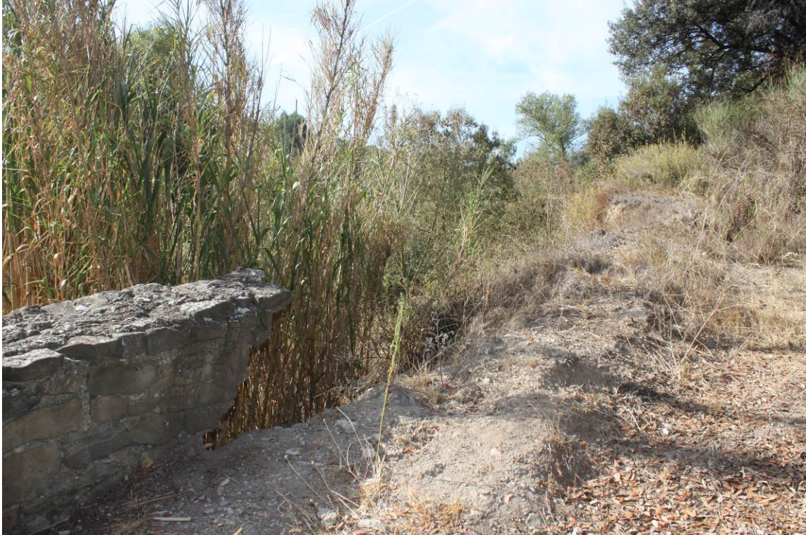
Fotografia 19. Erosió lateral del riu cardener sobre un Mur en el sector del Comtals
