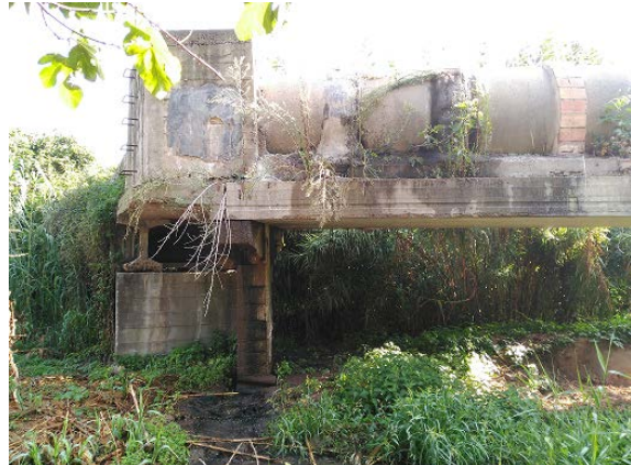
Figura 29. Punt on el col·lector d'aigües residuals té pèrdues evidents.
