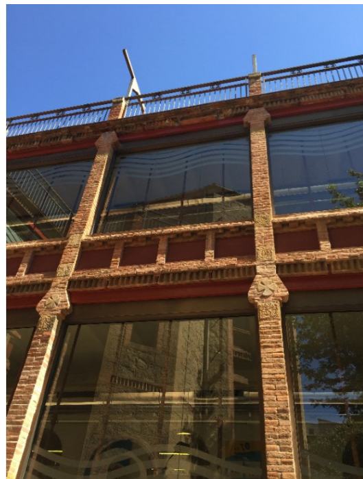
ESTAT ACTUAL - PATOLOGIES EXTERIORS
