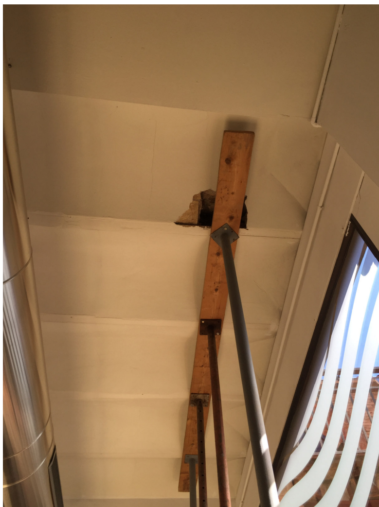
Apuntament Interior per Desgast Estructural
