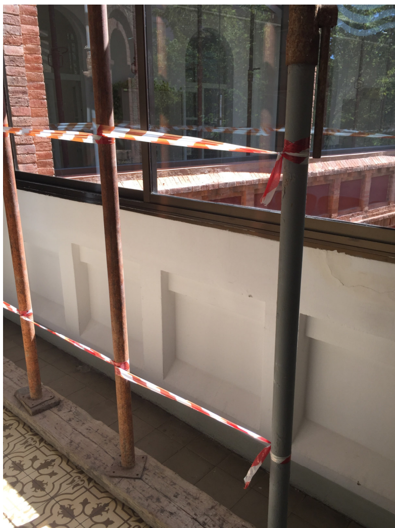
Apuntament Interior per Desgast Estructural
