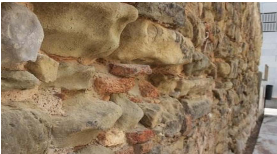
Detall de zona d'afectació per l'erosió del morter original i de les pedres que formen part de l'estructura
