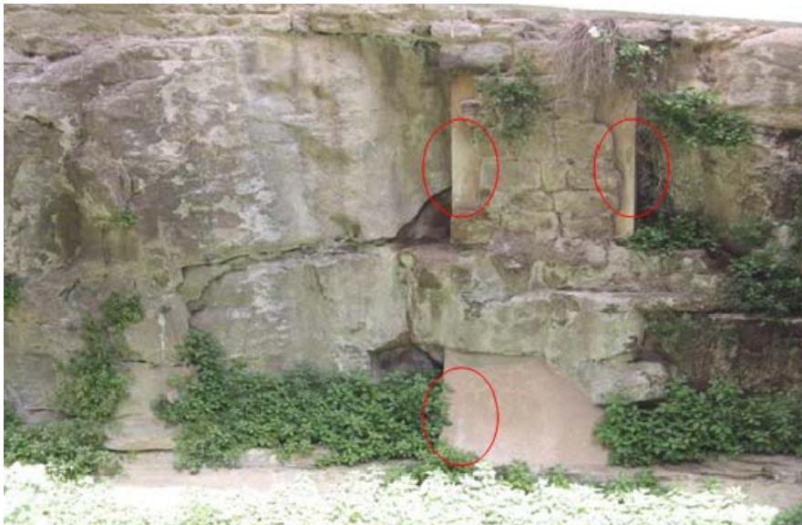
Part inferior del tram restaurat anteriorment. En vermell, indicació de zones amb salinització
