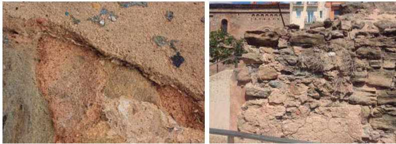
Disgregació, descohesió i fissuració d'arrebossats originals
