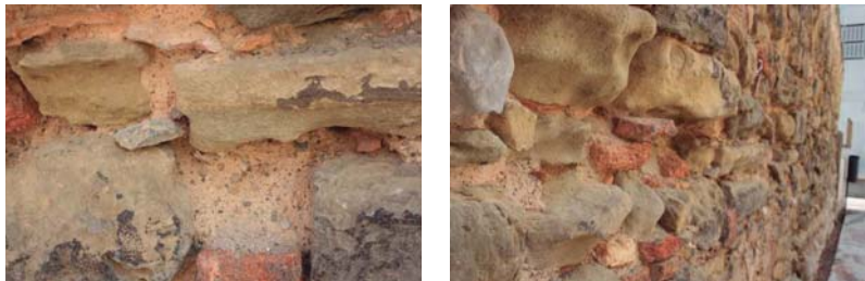
Erosió generalitzada de materials constructius originals
