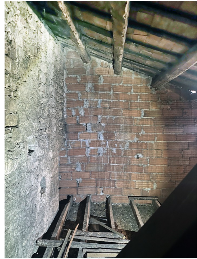
03 - AFECTACIÓ PER HUMITATS EN BIGUES DE FUSTA DE COBERTA
