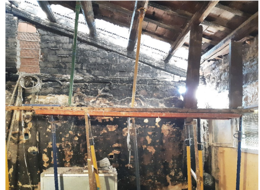
06 - AFECTACIÓ PER INCENDI EN ENCAVALLADA I BIGUES DE FUSTA
