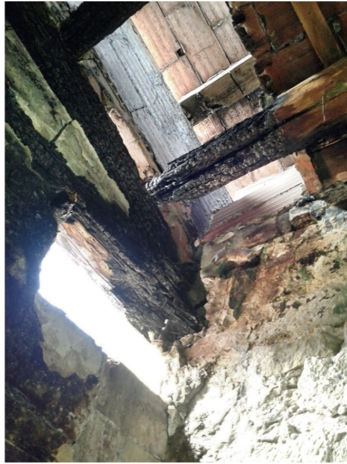
02 - AFECTACIÓ PER INCENDI EN ENCAVALLADA I BIGUES DE FUSTA
