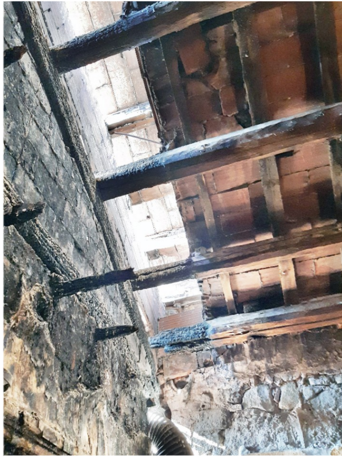
01 - AFECTACIÓ PER INCENDI CAP DE BIGUES DE FUSTA DE COBERTA
