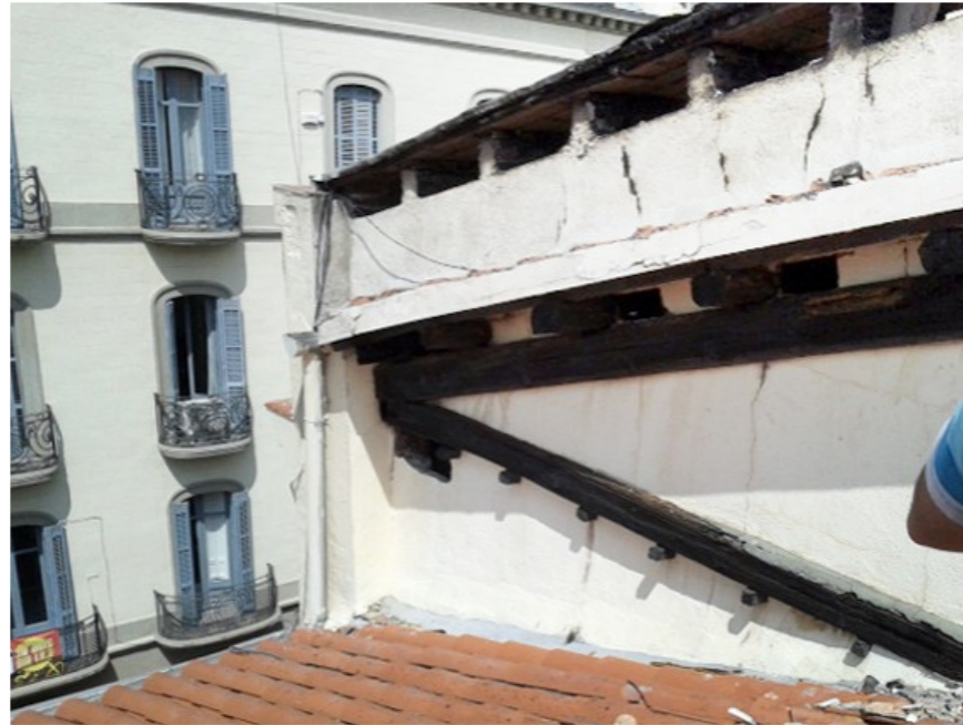
05 - AFECTACIÓ PER INCENDI EN ENCAVALLADA I BIGUES DE FUSTA
