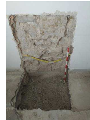
Fig.47.-Foto inicial del sol d'anivellació sorrenc (UE 1010) del sondeig 1, on s'aprecia la filera de maons arrebossats amb morter (UE 1011) a sota de la base de pedra (UE 1005) de l'arc 2 a la cala parietal 1.
