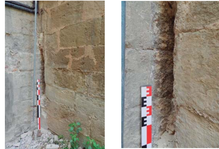
Vista de la cala 2.1. on s'observa el carreuat de l'edifici de Procuradors al qual s'hi entrega el mur dels Jutjats fet amb grans carreus de gres
