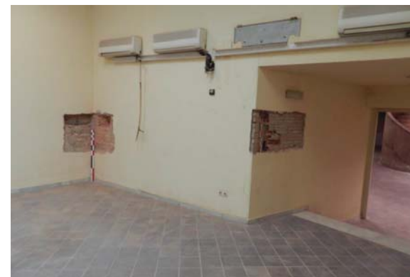
Vista de les cales 1.3 i 1.4 a l'interior de l'edifici de Procuradors, planta baixa Jutjats vells
