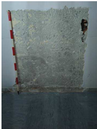
Fig. 23.-Fotografia de la capa de formigó i totxanes que componen l'envà que funciona a partir de la reforma de 1979.
