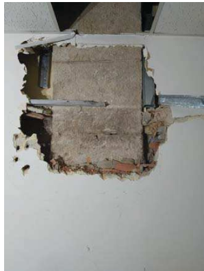
Fig.26.-Fotografia on es mostra l'arc amb la paret actual (un cop retirat l'envà), i els elements de suport que s'hi van posar a l'any 1979.
