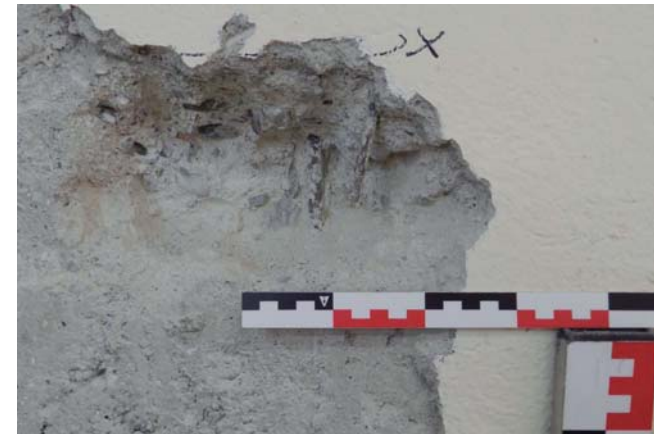
Cala 2.10. Detall on s'observa el ferro de l'armadura
