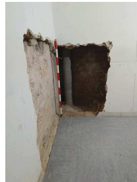
Fig.33.-Fotografia final de la Cala parietal 3 enfocada en el mur de tancament de la "sala gòtica".
