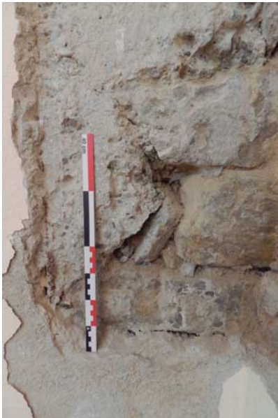
Cala 2.9. Detall de l'entrega del formigó sobre la pedra del mur medieval
