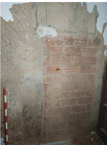
Fig.107.- Fotografia final de la Cala parietal 5 on s'observa la porta tapiada.
