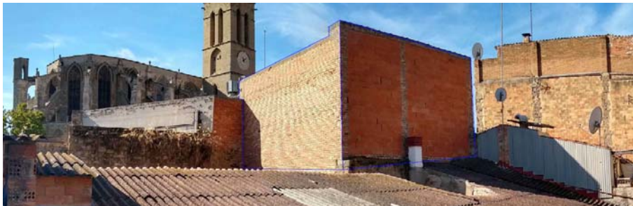
Vista des de l'interior d'illa, fent visible el cos afegit del s.XX
