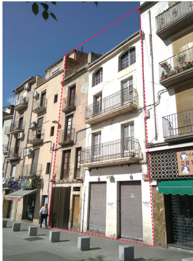
F2. VISTA FAÇANES EDIFICACIONS PLAÇA INFANTS - C/CARME INCLOSSES DINS DEL PMU DAMA ( A ENDERROCAR )
