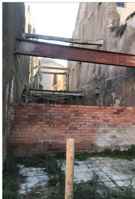
F4. ESTAT ACTUAL ANTIC ACCÉS CINEMA GOYA ( ACTUALMENT ENDERROCAT I FORA ÀMBIT PMU )
