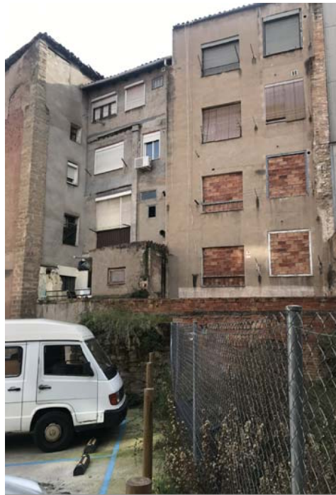
F3. FAÇANES PATI ILLA EDIFICIS C/ JOG DE LA PILOTA ( FINQUES ANTIGUES AMB ALGUNES FINESTRES TAPIADES )
