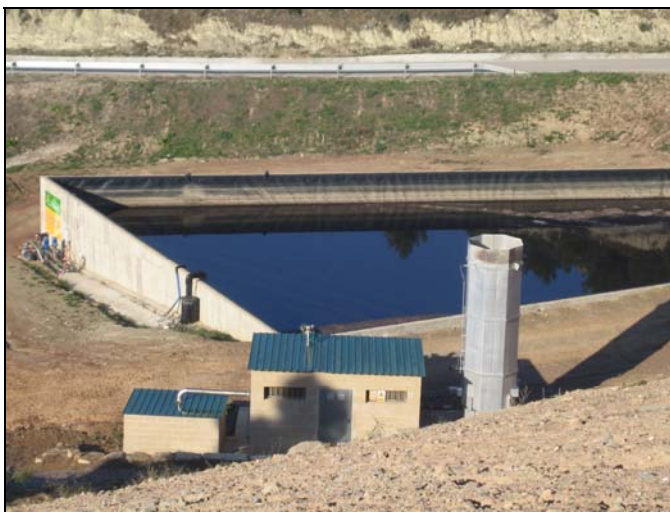
Imatge 7. Planta de tractament de lixiviats
