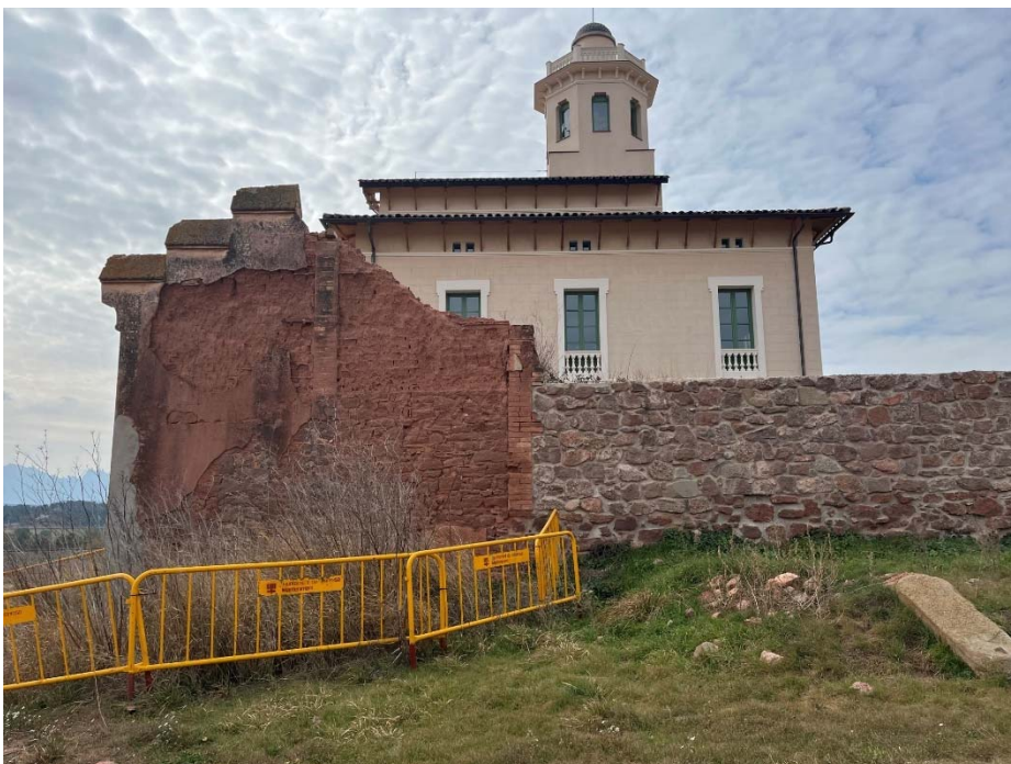
Construcció de les tines, unida a la Torre Lluvià amb la tanca. Font: Santamaria Arquitectes
