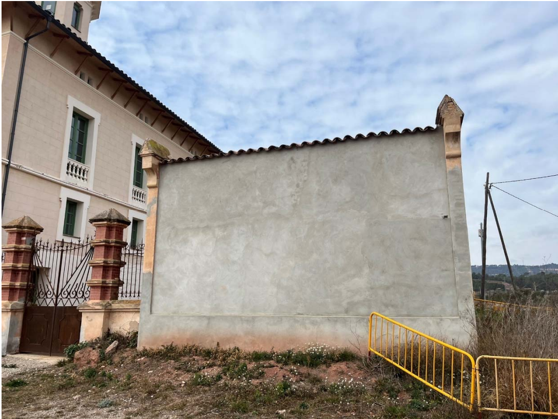
Estat actual façana sud amb revestiment de morter de ciment porland per evitar deteriorament
