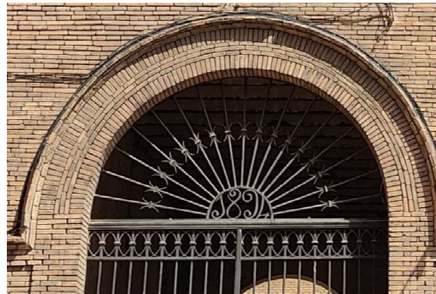
Gran arc d'accés a l'edifici al C. Llussà, al passatge alineat al C. De la Dama: arc de mig punt mixt (a sardinell i maó de pla) amb guardapols superior.
