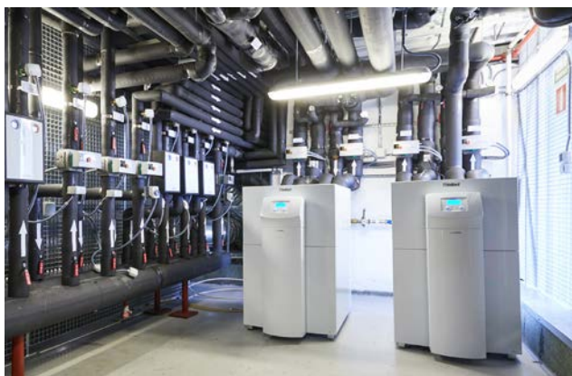
Implementació de la sala tècnica
