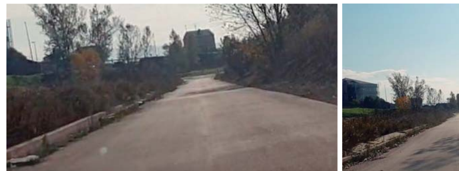
Secció executada, el primer tram es va executar la vorada però no la rigola. Al marge dret, no es va executar cap límit de calçada ni cap cuneta per a conduir les aigües.
