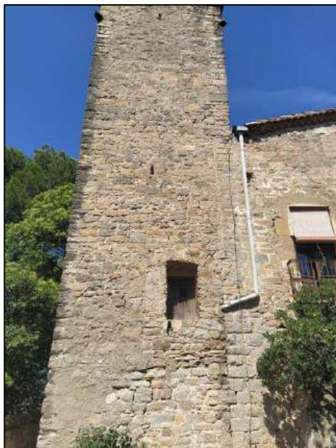
Foto 6. Torre sud-oest. Esquerdes a la façana
