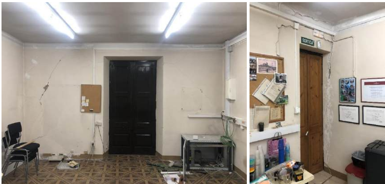
230920-148 i 230920-152. Afectació d'esquerdes de directriu vertical als murs de la sala nord-est de la planta primera.
