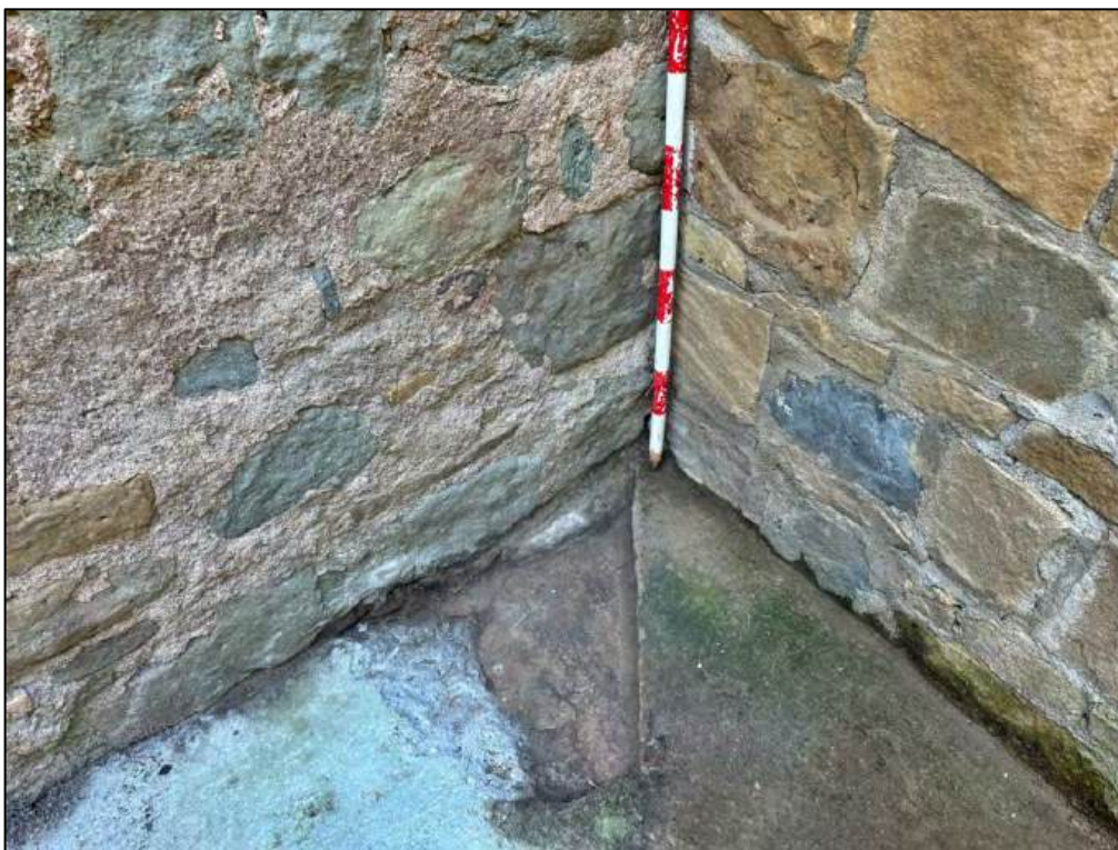
Figura 10. La cala inicial C2 es va traslladar de lloc en trobar un estrat resistent de formigó
