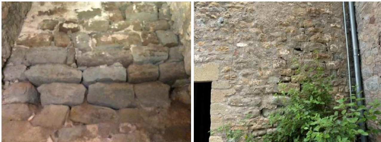
230920-309 i 240628-055. Exemples de trams amb pèrdues de morter a les juntes d'obra de fàbrica de paredat a l'arrencada de les façanes del volum d'escaleres de cargol, i a part de la façana sud, respectivament.
