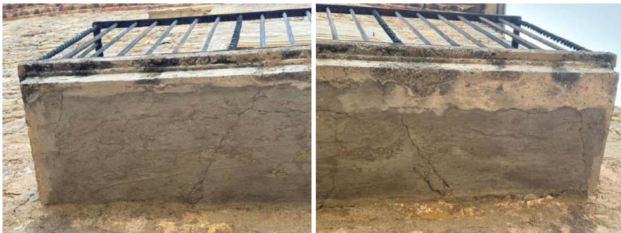
240628-46 i 240628-45. Exemple de fissuració a la cara inferior de la llosa d'un balcó del primer pis a la façana oest.
