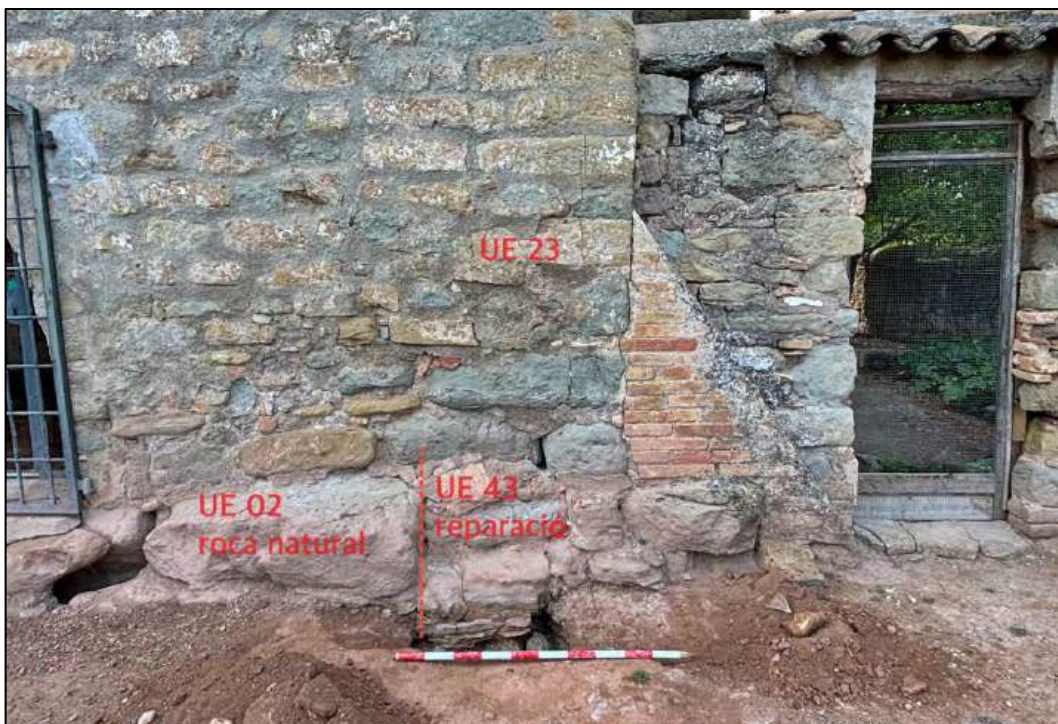
Figura 24. CALA 6. Relació estratigràfica. L'erosió de la roca natural sobre la qual s'aixeca el mur UE 23 ha motivat una reparació
