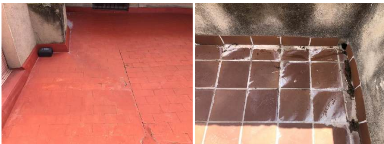
230920-168 i 230920-261. Exemples de trams de terrats a la planta primera i al capdamunt de la torre, amb esquerdes als paviments, acumulació de dipòsits de sediments que indiquen entollaments freqüents, i afectacions de filtracions de diversa magnitud als sostres inferiors.
