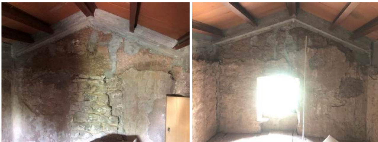
230920-117 i 230920-114. Afectació d'esquerdes de directriu vertical als murs de la planta sotacoberta del volum annex nord-oest.
