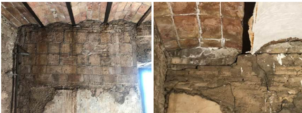
230920-238 i 230920-232. Estat de corrosió de les biguetes del sostre del nivell superior de la torre sud-est.
