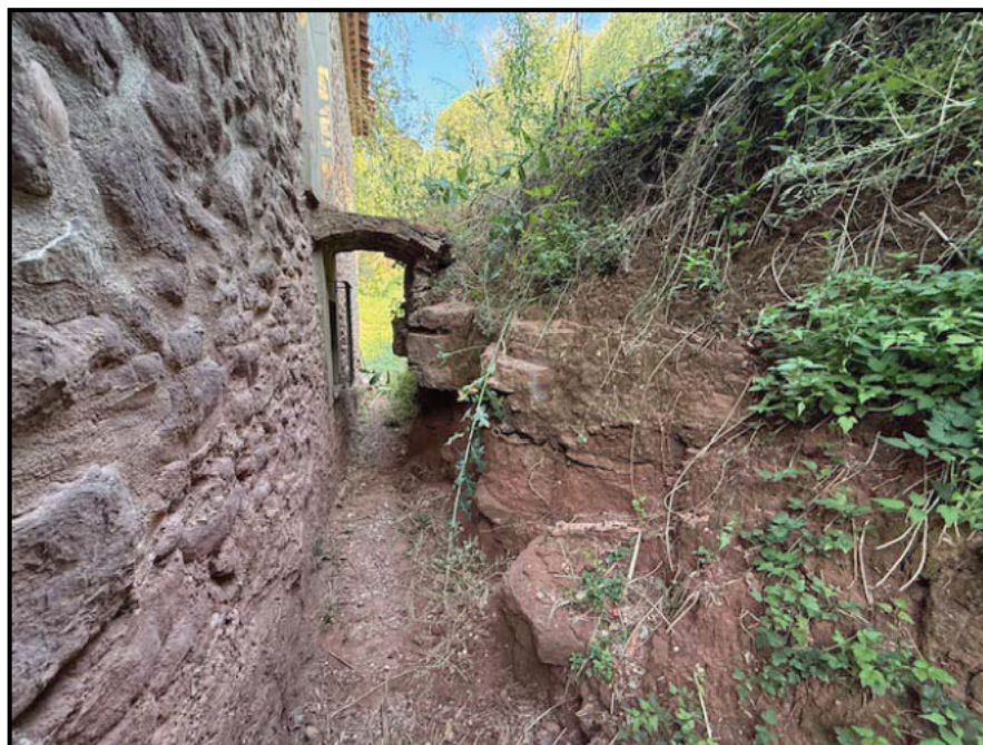
Foto 2. Talús de la zona A, darrera de la casa.
