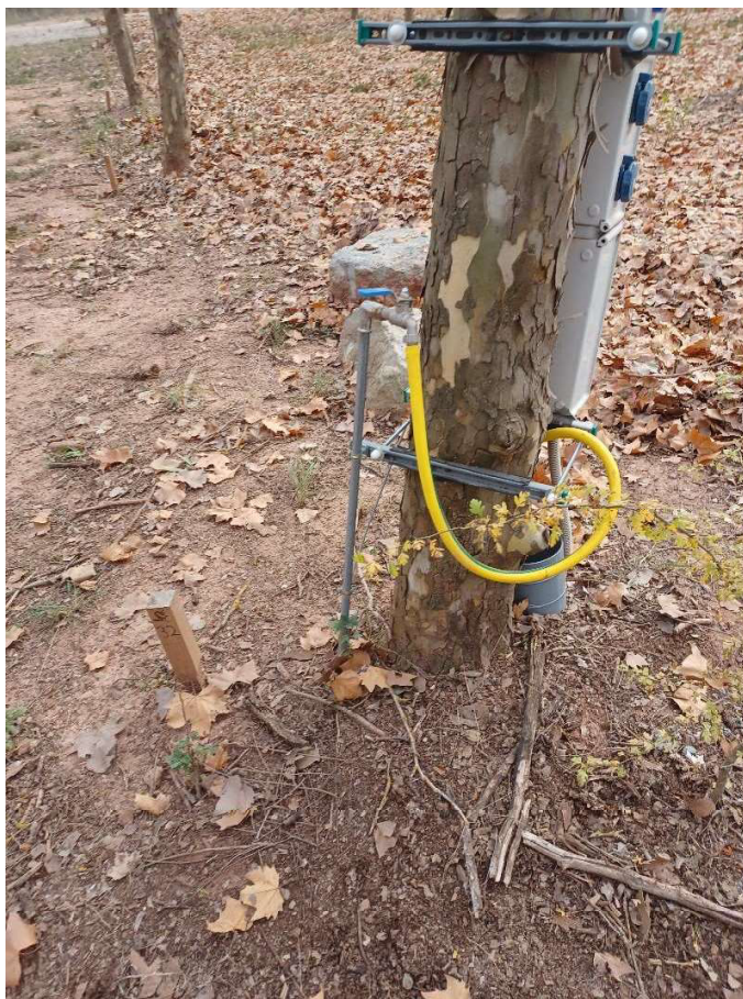
FOTO 11 Presa d'aigua, sense pavimentar, ni dotada de desguàs, fixada en arbre, juntament amb torre de distribució elèctrica
