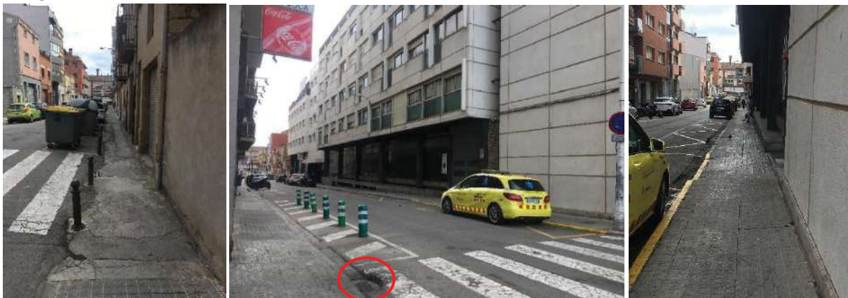
Imatge 5. Estat de les voreres Carrer Flor de Lis
