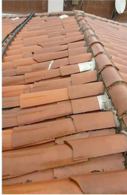
teules trencades coberta
