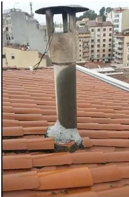
sortida xemeneia coberta sense impermeabilitzar
