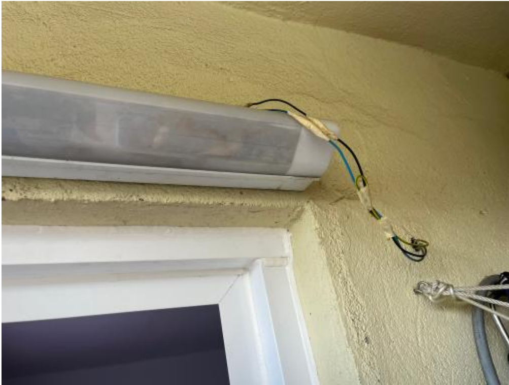
deficient inst. elèctrica
