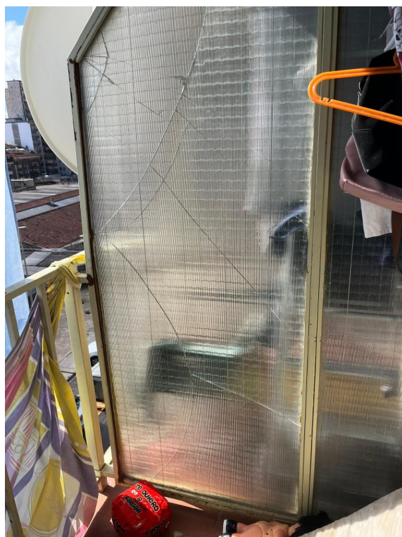
vidre armat trencat sepració veïns
