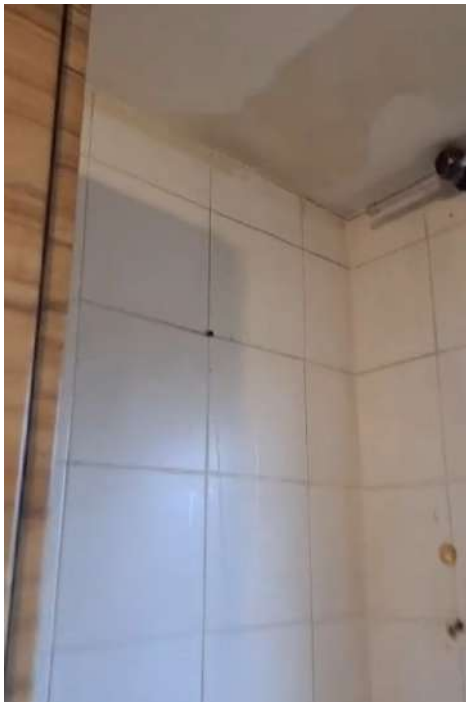
Fig. Patologies generades pel baixant de fibrociment. Estat actual.
