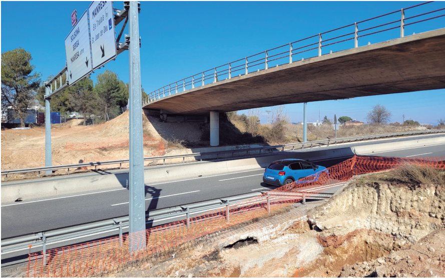
Imatge de l'inici de les obres de construcció de la nova passarel·la, a començaments de març
