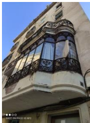
Balcons en mal estat
